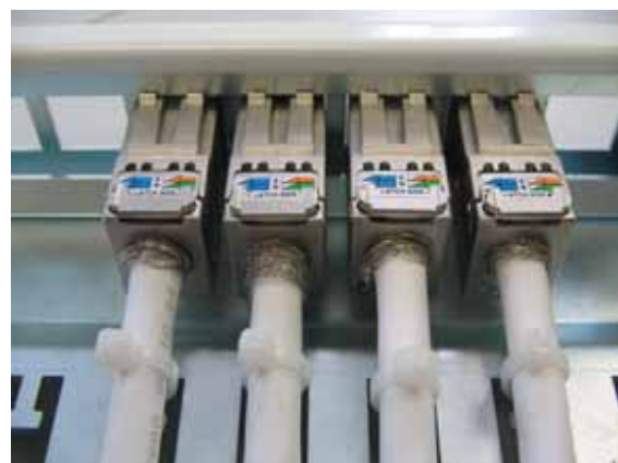
Bild 69: Im Panel angeschlossene Installierte Einzel-Jacks
