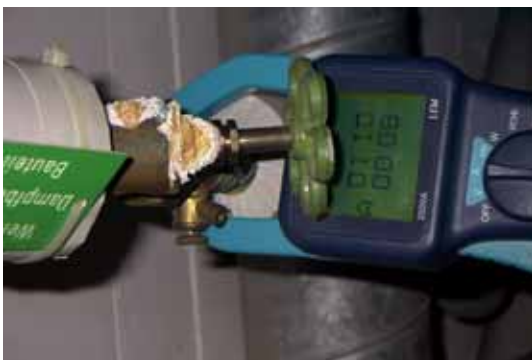
Bild 34: Korrodiertes Wasserrohr (GHMT AG)
