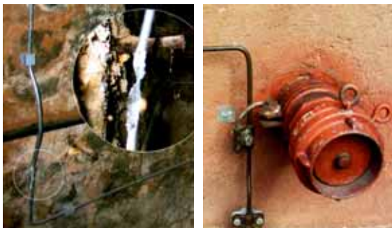
Bild 26: Korrosion als Folge von unterschiedlichen Materialien
