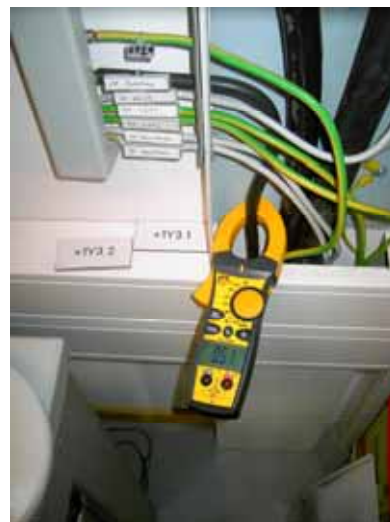
Bild 35: Strom auf dem PE (Patzke Consulting)
