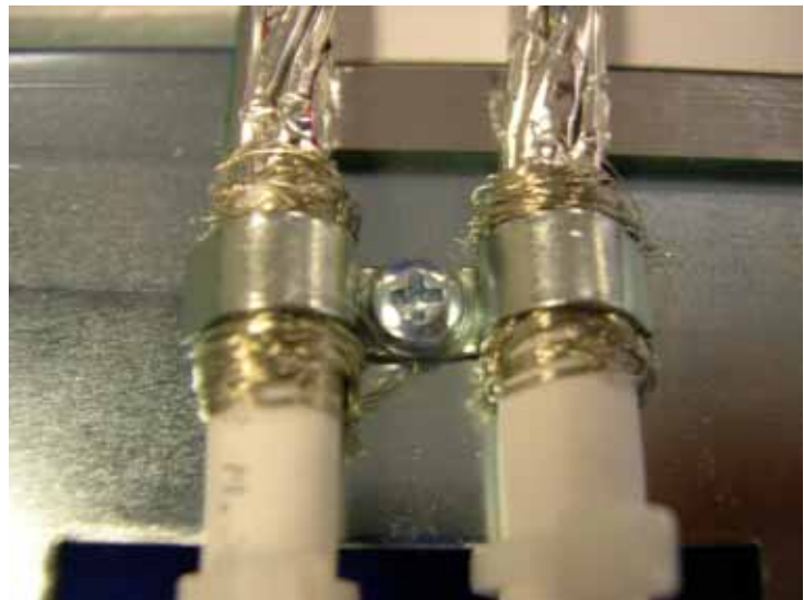
Bild 68: Erdungs-Anschluss mit Kabelklemmen auf Leiterplatten- Panel
