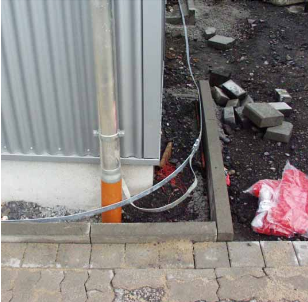
Fig 22: Stahlband ist nicht tief genug im Boden verlegt (Obo Bettermann)
