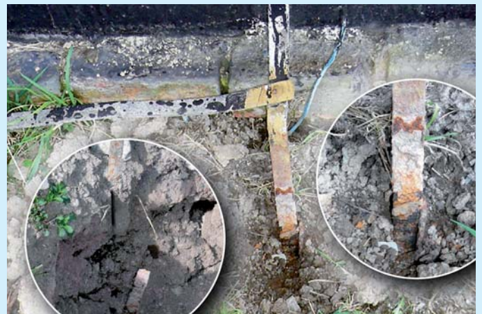
1 Korrodiertes Erder nach etwa 30 Jahren im Erdreich
