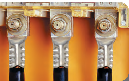
Die Kerbung ist eine nach wie vor zulässige Pressform, die häufig im Schaltschrankbau bis 1000 V genutzt wird
