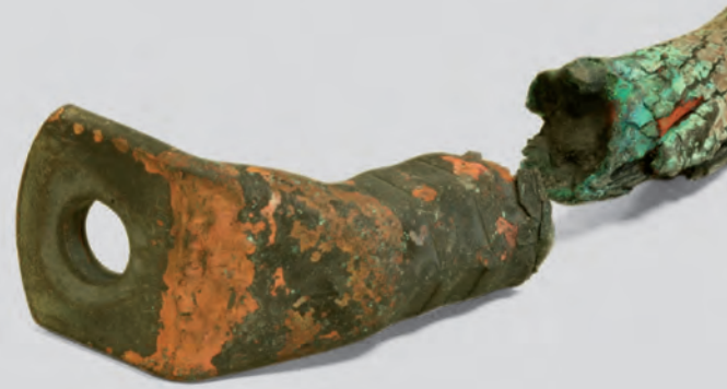
Kabelschuhe schlechter Qualität und/oder schlechte Verarbeitung können zu Bränden führen
