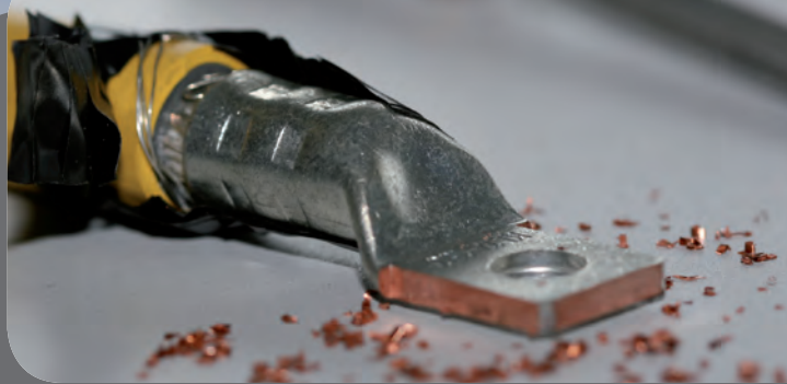
Nicht fachgerecht verarbeitete und individuell angepasste Kabelschuhe können zu gravierenden Sicherheitsmängeln an elektrischen Installationen führen.
